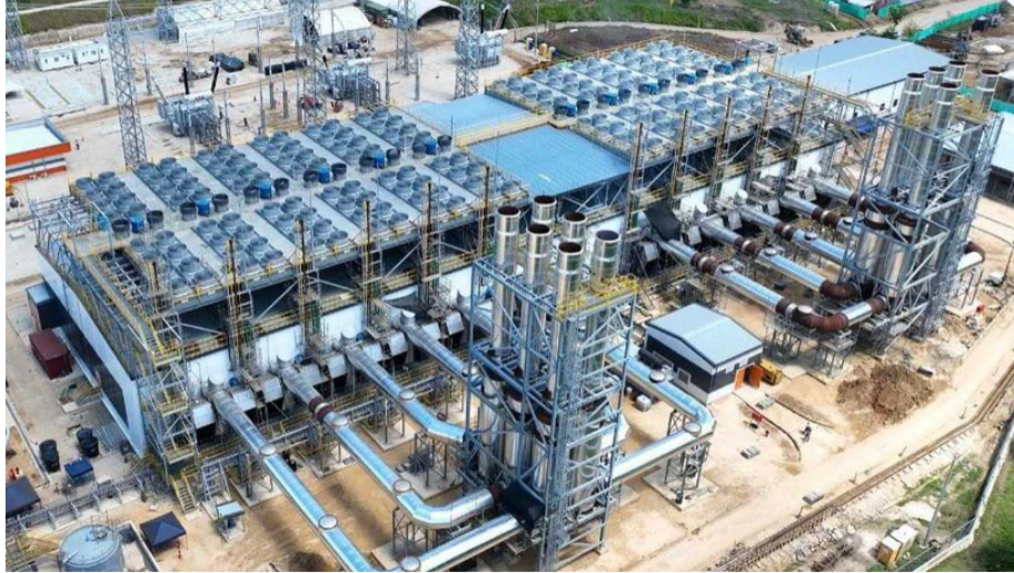
Esta termoeléctrica a gas natural tiene una capacidad de 200 megavatios. - Foto: Twitter @Celsia_Energia
