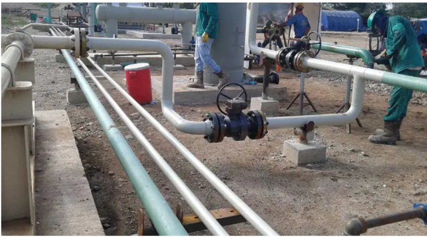
El pozo Bullerengue cerca de Sabanalarga está en producción de gas.
