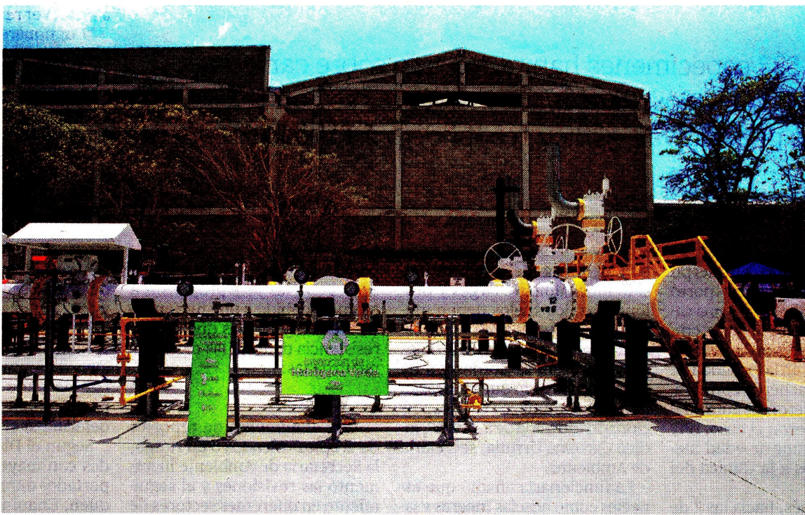
La planta piloto de Promigás producirá 15 toneladas de hidrógeno al año. FOTO: MINMINAS
