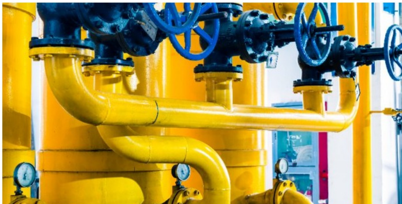
Planta de gas Cupiagua. Foto: Llanogás.
