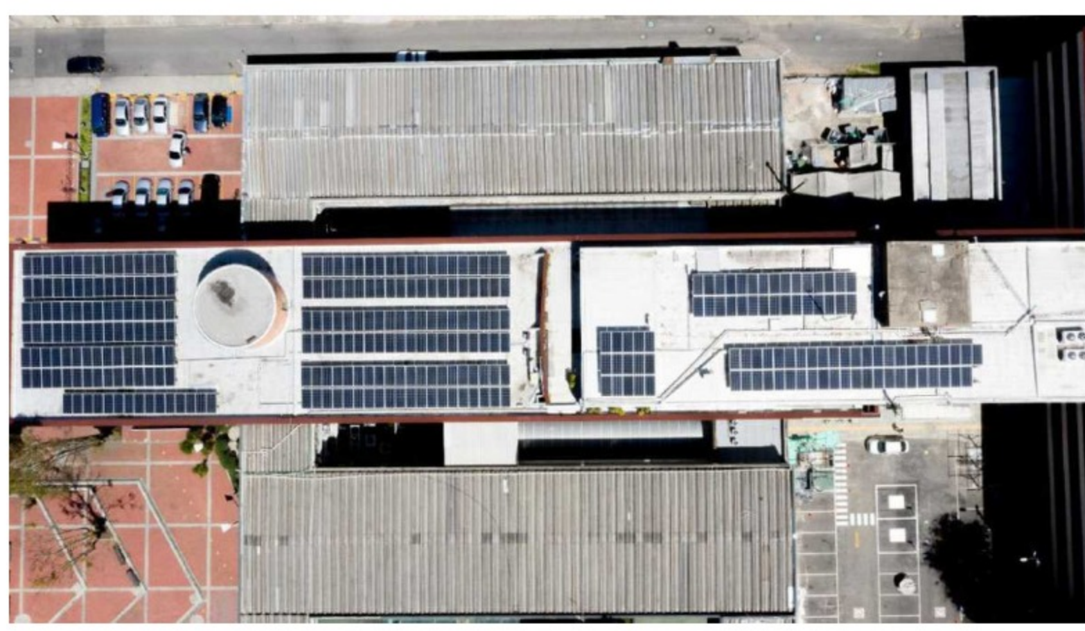
Paneles solares - Foto: Ministerio de Minas y Energía
