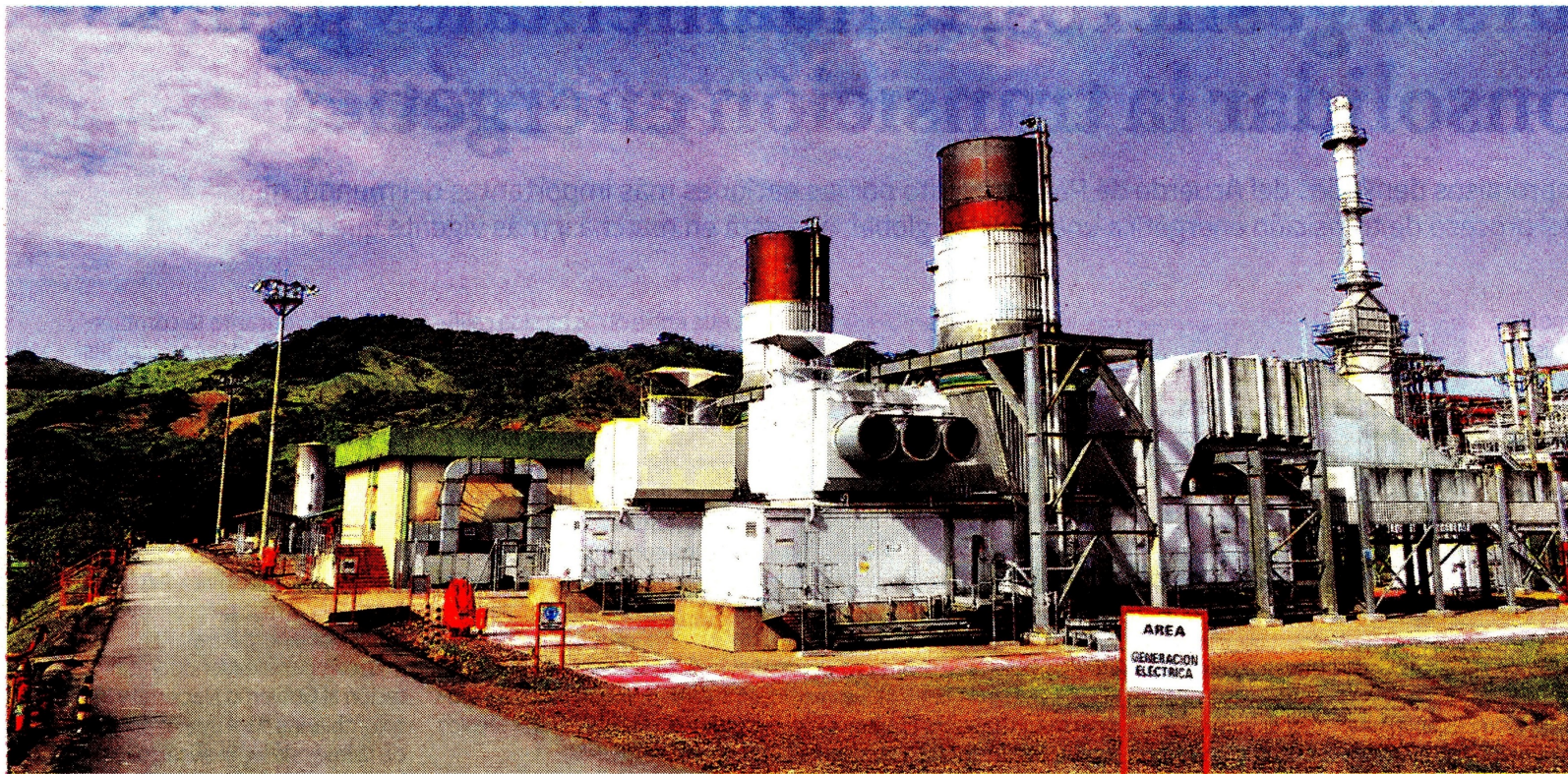
Cupiagua, localizado en Aguazul, tiene una planta con capacidad de ventas de 210 millones de pies cúbicos de gas natural por día. Cortesía: Ecopetrol
