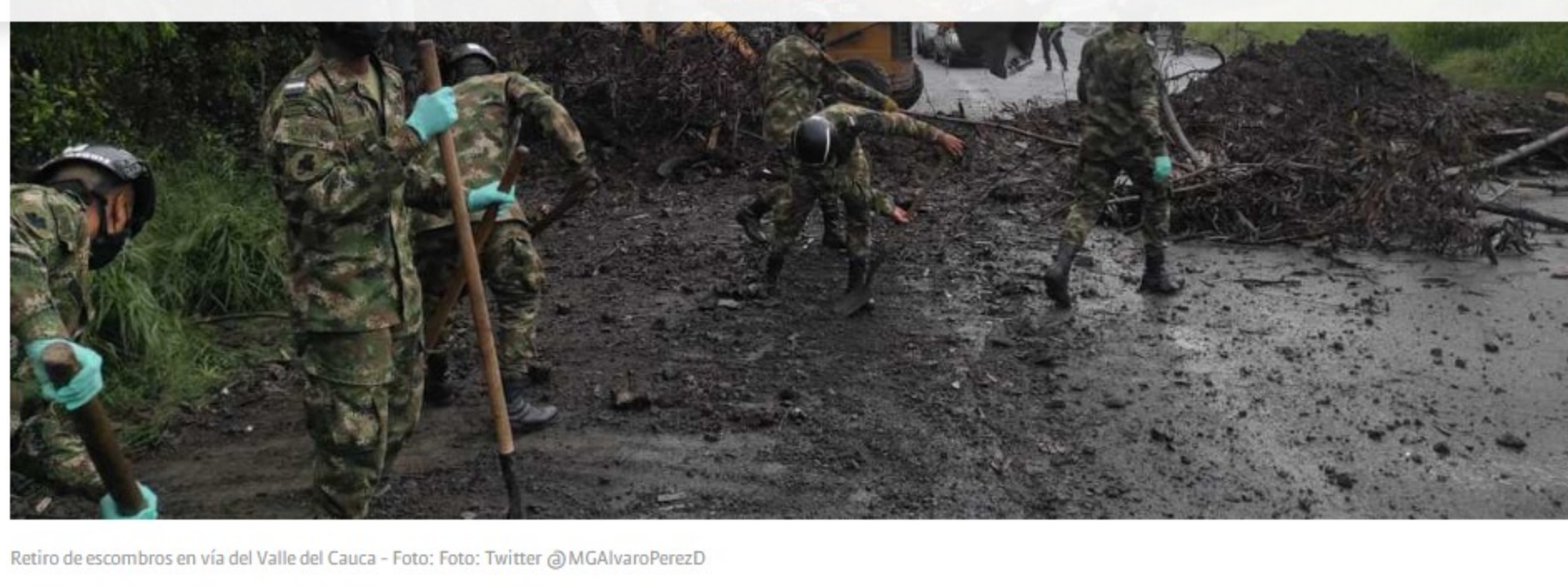
Retiro de escombros en vía del Valle del Cauca - Foto: Twitter @MGAlvaroPerezD
