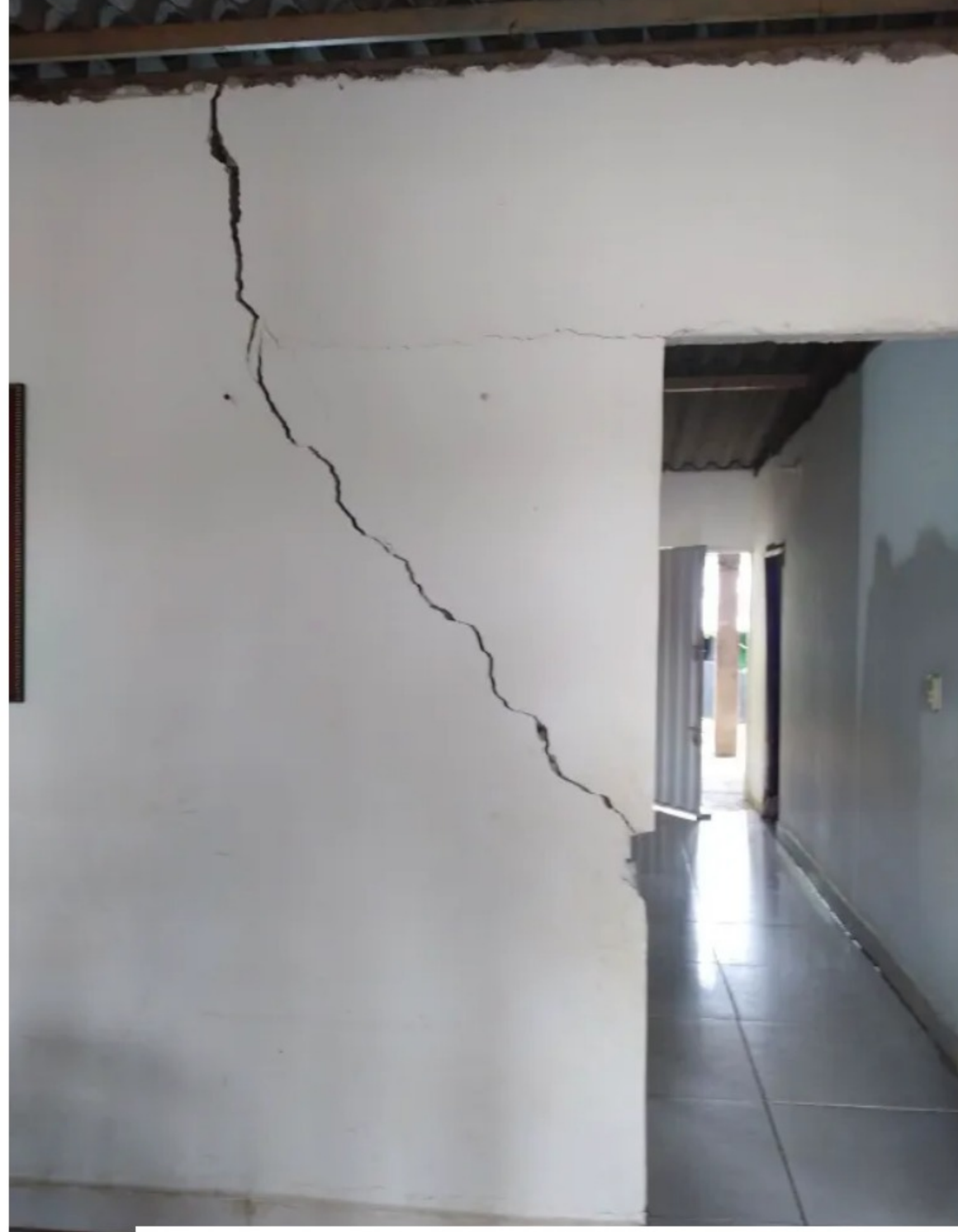
Vivienda afectada en la vereda Campo 16, municipio Barrancabermeja-Santander.
