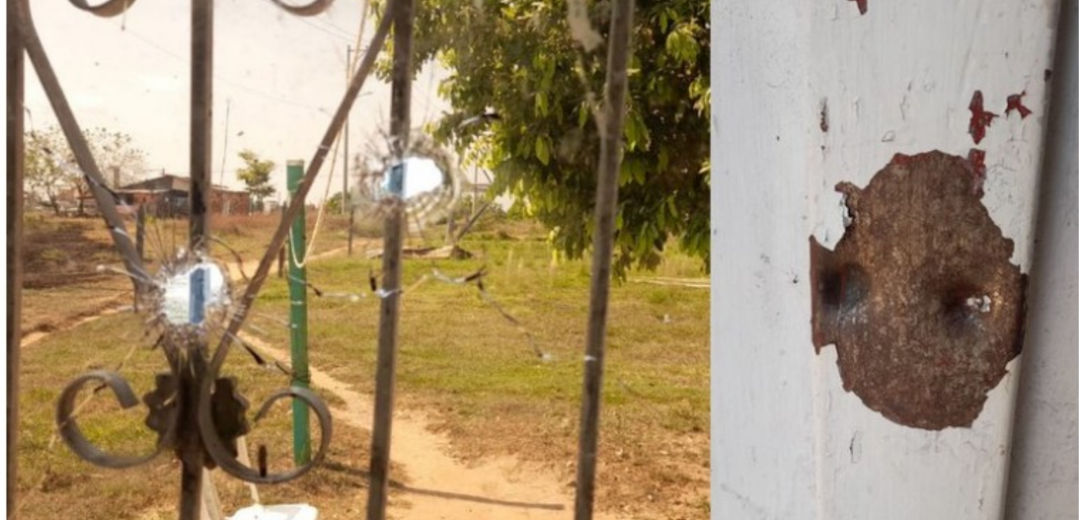
Impactos de bala que atravesaron la edificación de la vivienda de Velázquez / (Twitter: @elcarlosjuan).
