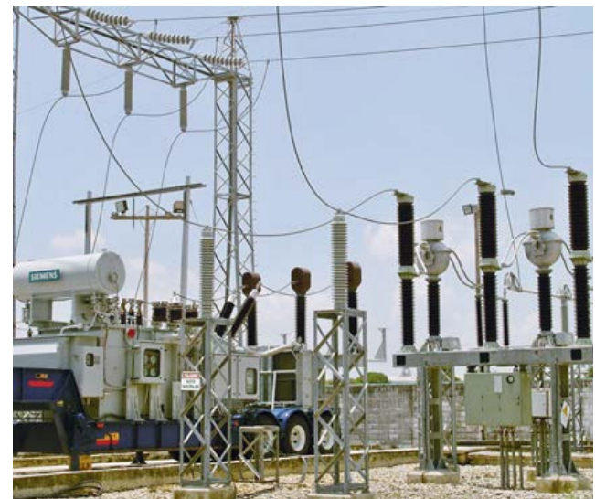
Panorámica de la subestación Silencio.
