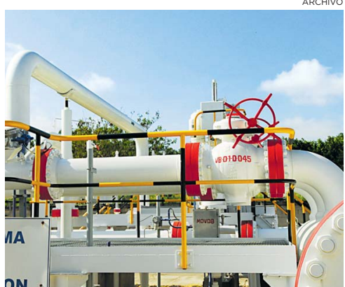
Infraestructura de un gasoducto en la Costa.
