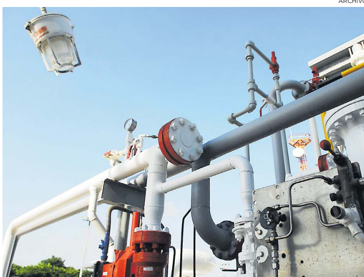
Equipos en una estación de un gasoducto de Promigas.
