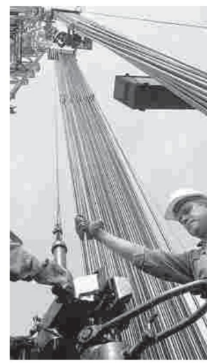
Al finalizar el 2020, el bombeo llegaría a 740.000 bpd.
