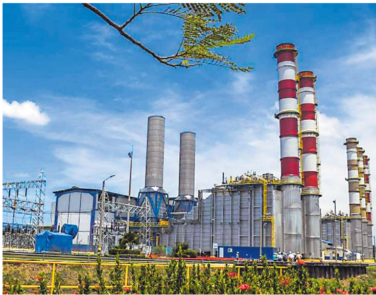
Tebsa, compañía que genera energía a través de térmicas.
