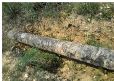
El gasoducto de 12 pulgadas donde se instaló una válvula ilegal (Foto Ecopetrol)
