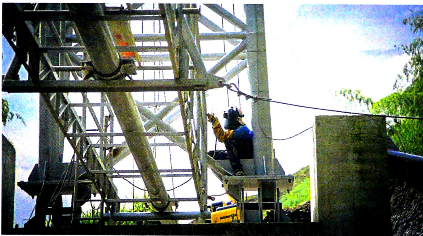
La ampliación en el sistema de transporte busca llevar por los ductos 100.000 barriles adicionales por día. Ecopetrol
