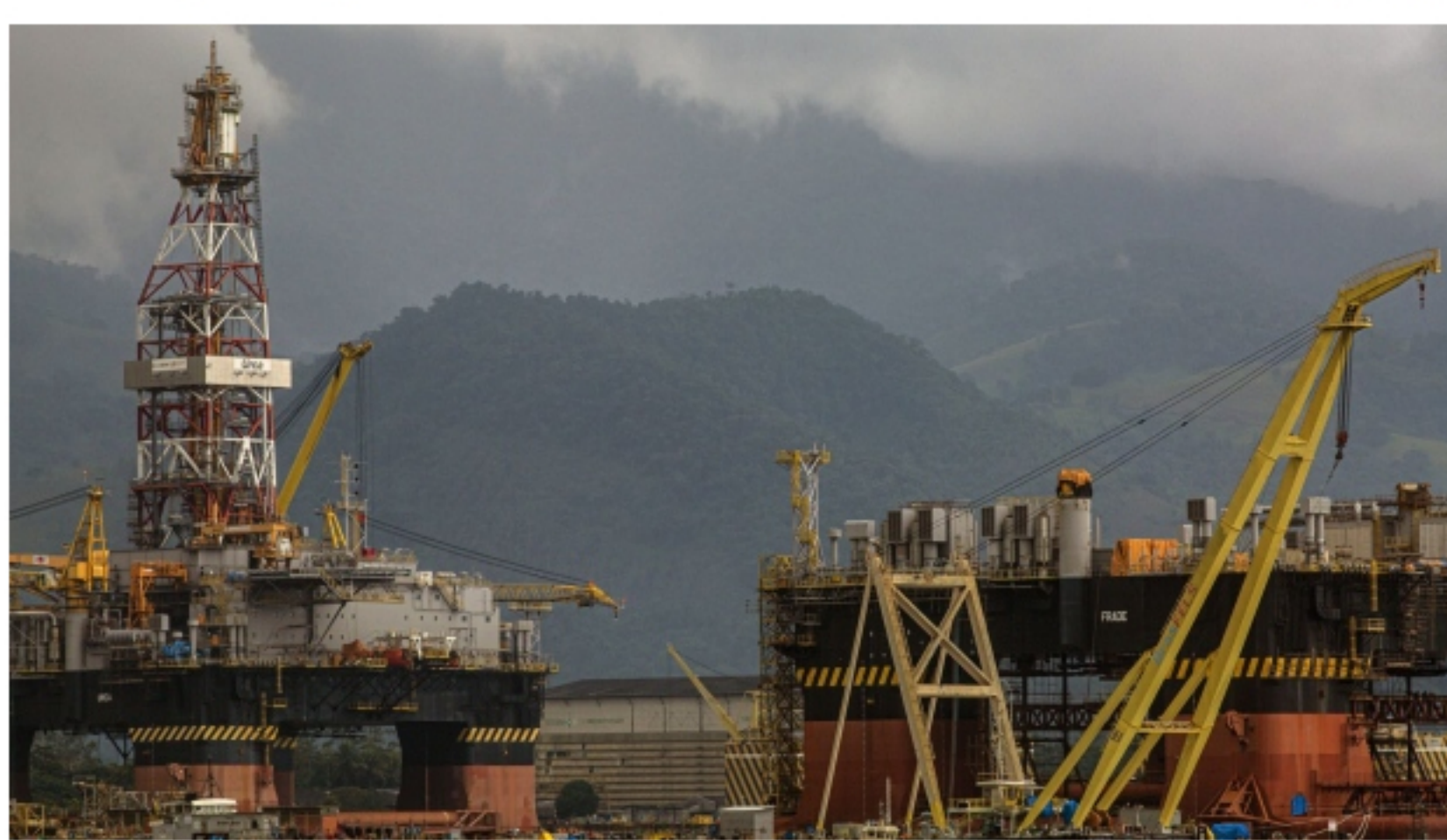
Plataformas de Petrobras en construcción en el estillero Verolme cerca de Río. Fotógrafo: Dado Galdieri / Bloomberg, Bloomberg
