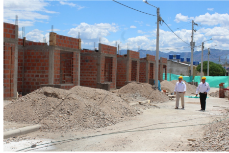
El proyecto de vivienda Las Marías en Aipe, avanza en un 76% de ejecución.
