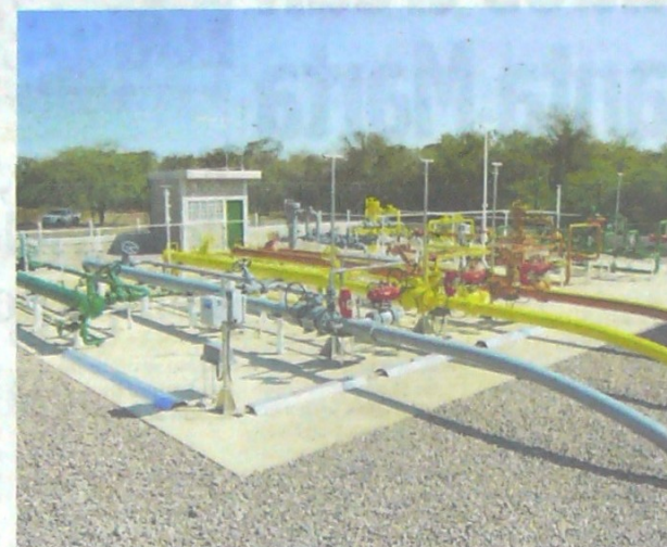
Subestación de Gases del Caribe en su zona de cobertura en la Costa.
