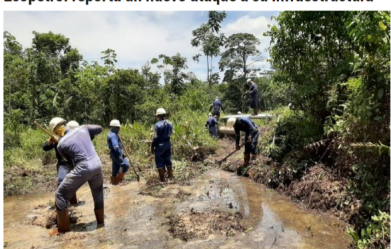
Contratistas de Ecopetrol atendieron la emergencia generada por el ataque vandálico. FOTO Cortesía Ecopetrol
