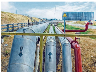
El gasoducto Antonio Ricaurte tiene capacidad de 500 millones de pies cúbicos de gas. ISTOCK
