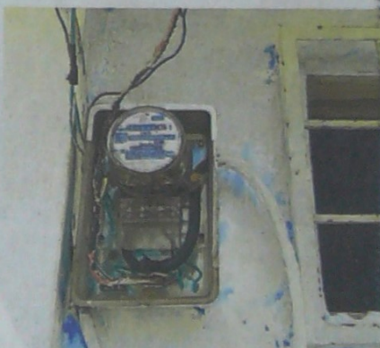
Estos son el cable y el contador que se afectaron con el hecho.
