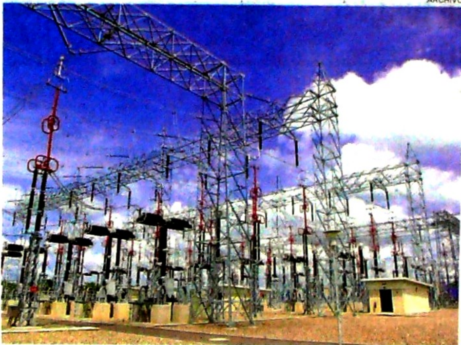
Una estación de la empresa Interconexión Eléctrica ISA S.A.
