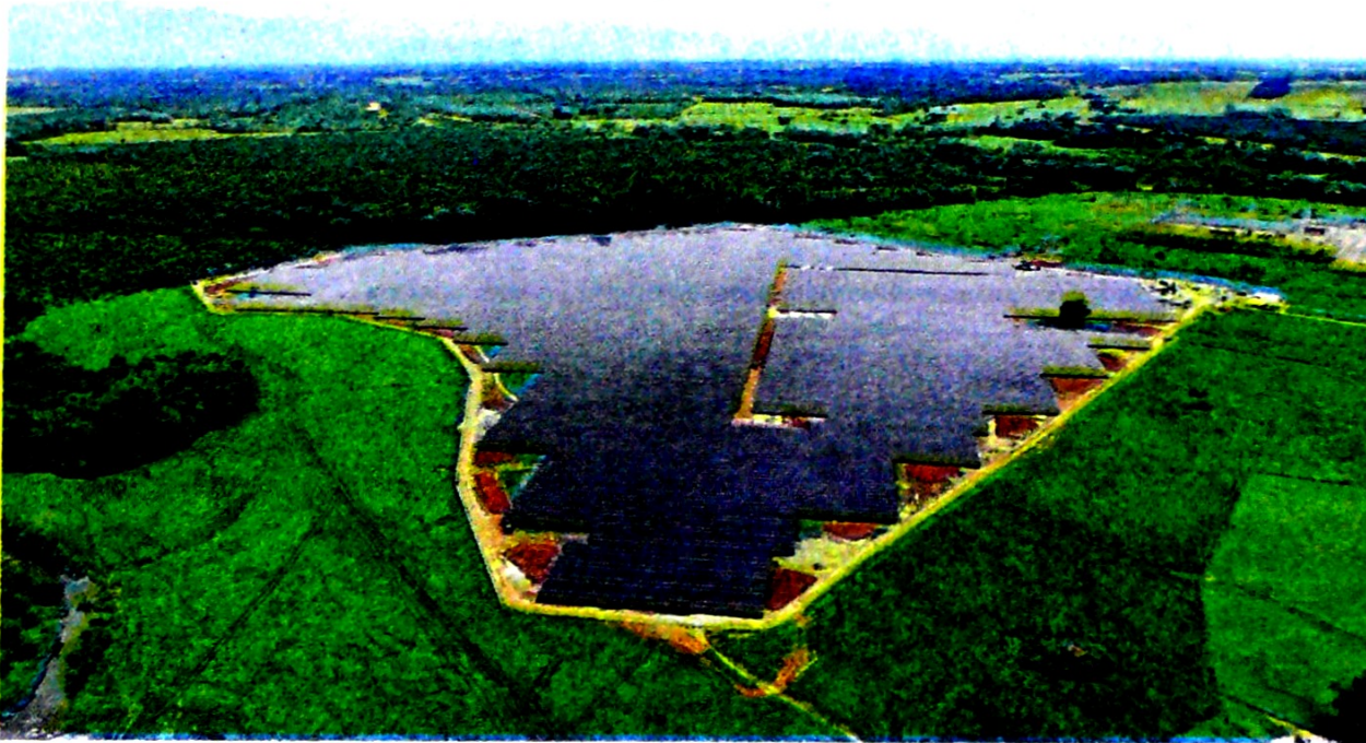
El Parque Solar Castilla fue construido por AES Colombia bajo un contrato de suministro de energía por 15 años. Cortesía Ecopetrol
