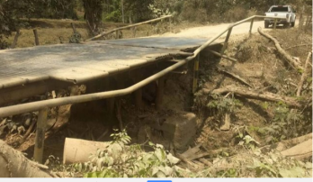
En total son tres puentes los que debería mejorar la empresa Ecopetrol como parte de la estrategia de obras por impuestos. / Foto: Archivo de obras por impuestos.
