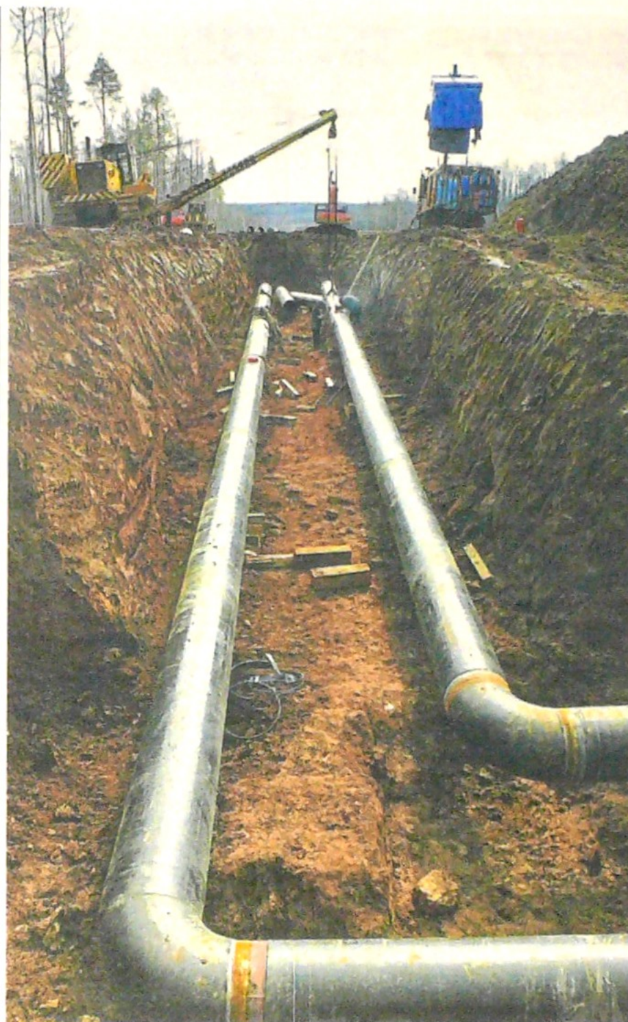
La tubería, comenzó a ser tendida en paralelo al sistema de transporte que ya existe. Archivo /
