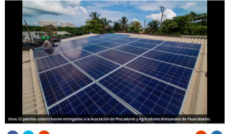
Unos 32 paneles solares fueron entregados a la Asociación de Pescadores y Agricultores Artesanales de Pasacaballos.
