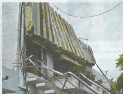
Parte de techo de la vivienda se desplomó.
