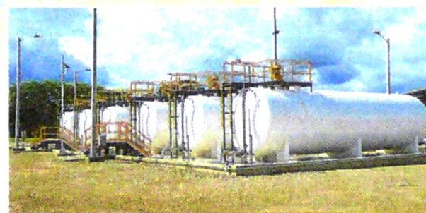
El oleoducto tiene 836 km en tierra y 12 km en el mar.
