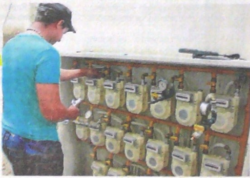
EL PROYECTO DE LA GOBERNACIÓN busca ampliar las redes de gas domiciliario a los municipios del Catatumbo que no tienen buena cobertura.
