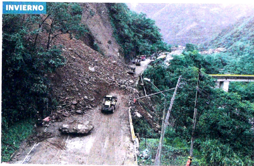
Coviandes entregará hoy un reporte sobre el estado de los tramos afectados. Carlos Ortega
