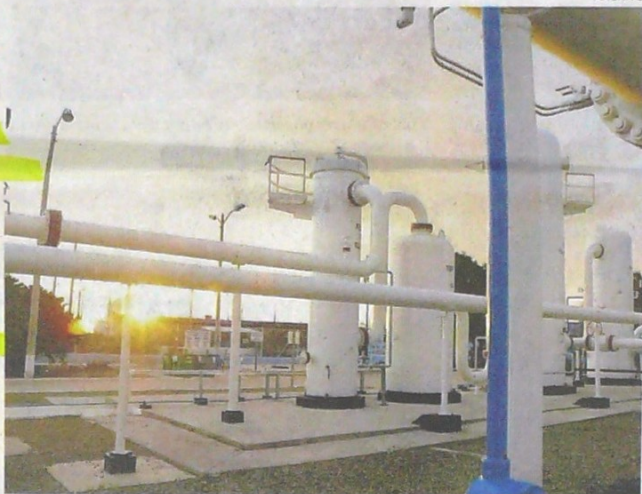
Infraestructura de una subestación de gas natural en la Costa Caribe.
