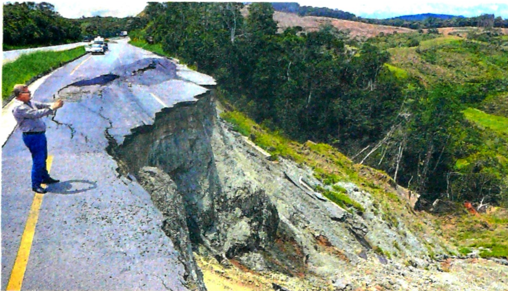
En la vía Buga-Buenaventura, una de las que la CCI considera prioridad, se han registrado desprendimientos. Santiago Saldarriaga/CEET
