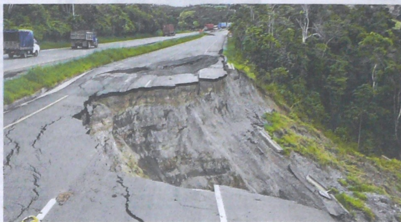
Adiós a la vía. Por causas aún no establecidas con certeza un tramo del corredor entre Buenaventura y Mediacanoa se desfondó. Esto ocurrió en el kilómetro 89, cerca al municipio de Restrepo, Valle, a finales de marzo.
