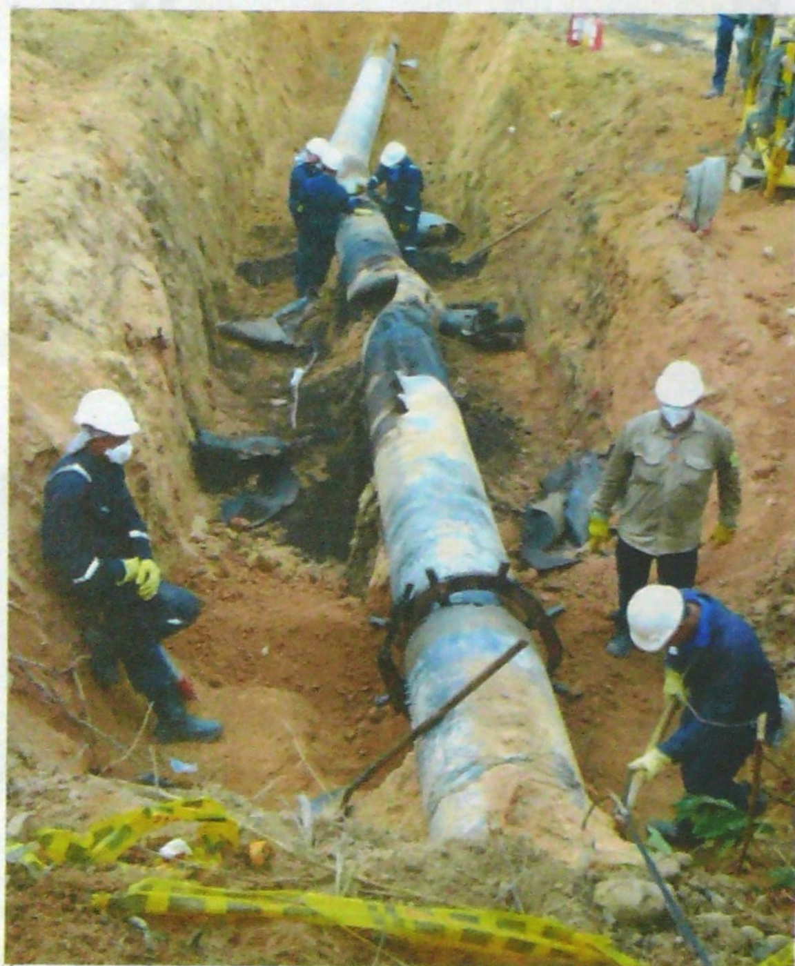
Ecopetrol ha tenido que invertir más de $251.000 millones de pesos en los últimos cinco años para reparar los daños causados por ataques terroristas.
