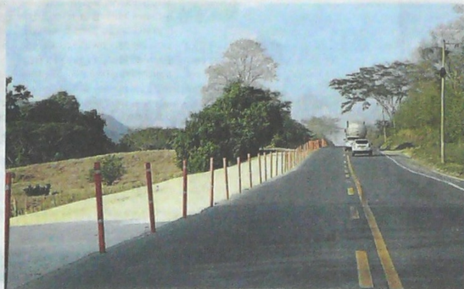
Transversal de los Montes de María. Varias vías se necesitan para interconectar corregimientos y municipios con esta importante arteria.//EL UNIVERSAL.
