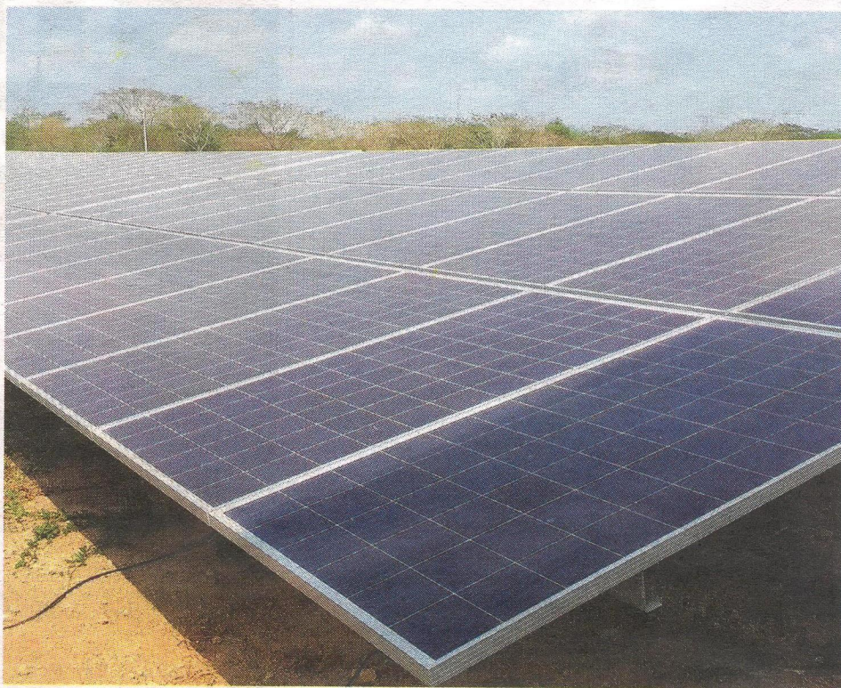
Paneles solares que conforman la Granja Solar Celsia en Santa Rosa, Bolívar.
