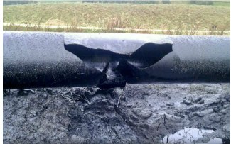
El ataque produjo la rotura de una tubería y posterior derrame de crudo en la quebrada La Piñuela. / Foto Twitter @Ecopetrol
