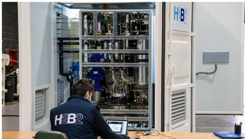
Instalaciones de H2B2
