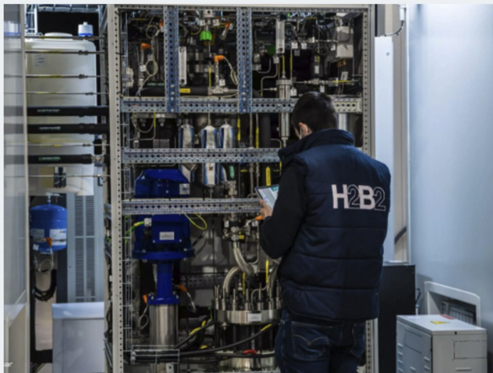
Estación de producción de hidrógeno verde de H2B2. FOTO:H2B2
