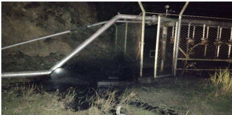
Las explosiones ocurrieron en campo de Ecopetrol en Barrancabermeja/Foto: @RCNBga/Twitter.
