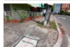
Cable electrificado quedó expuesto en la carrera 28, en Barrancabermeja
