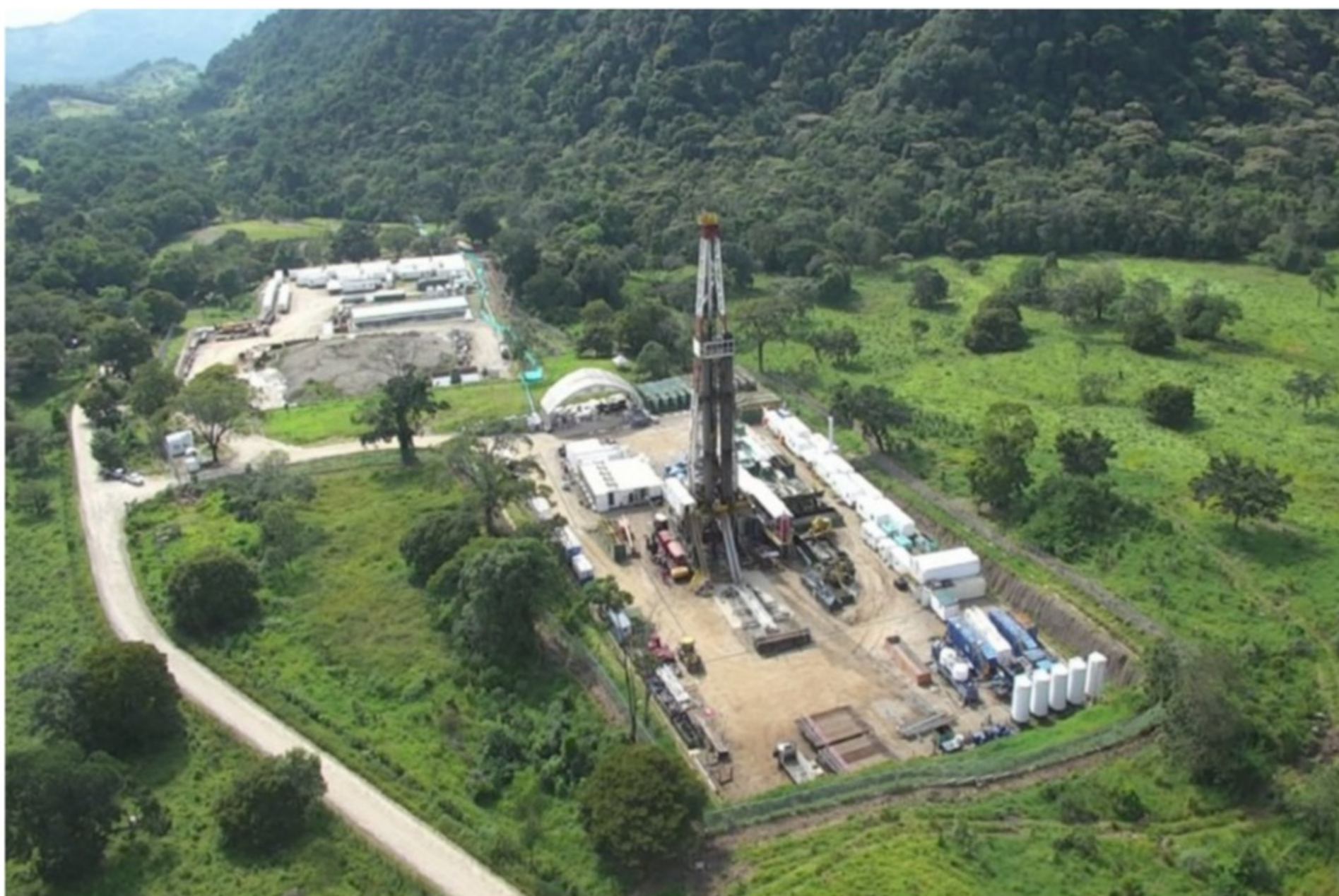
Pozo Ecopetrol en Aguazul, Casanare
