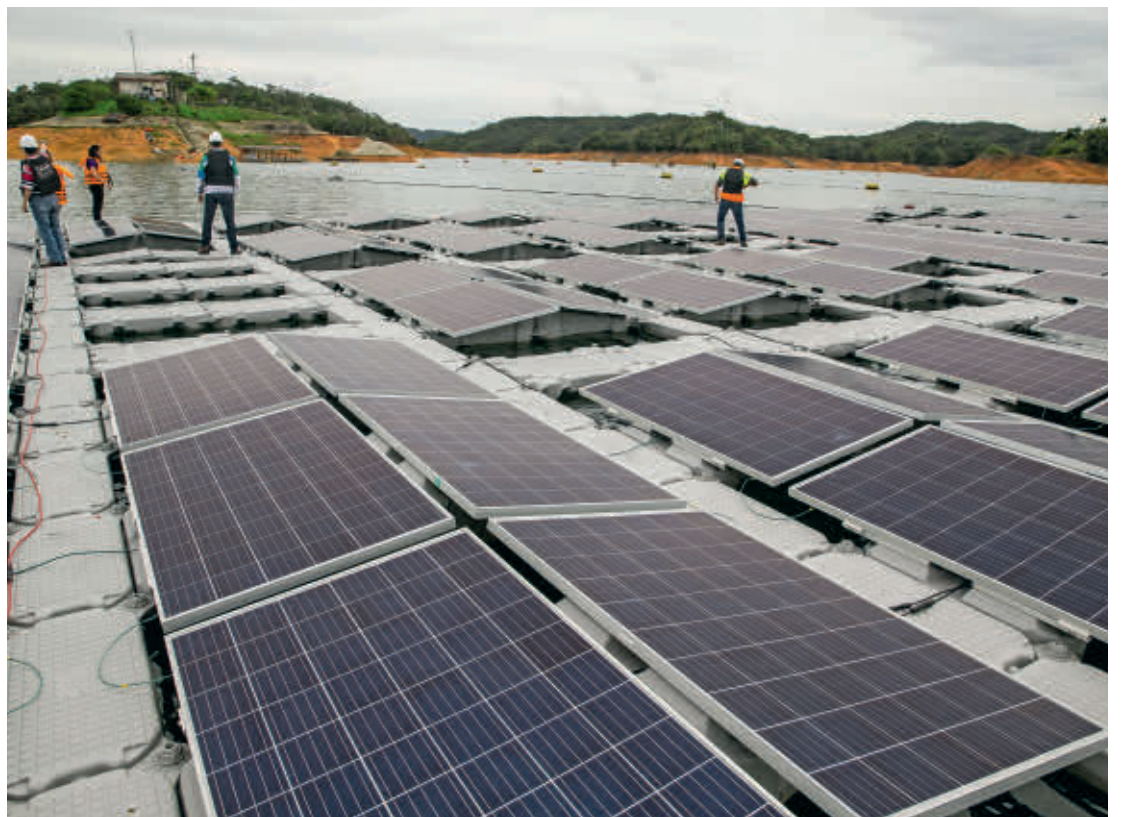
Según el Ministerio de Minas y Energía el país cuenta con más de 248 megavatios de capacidad instalada para la generación de energía renovable no convencional. FOTO ESTEBAN VANEGAS
