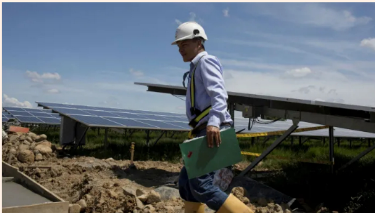
Planta solar de Ecopetrol en Castilla La Nueva, Colombia. La compañía quiere que la energía renovable cubra la mitad de sus necesidades para 2025 © Nicolo Filippo / Bloomberg
