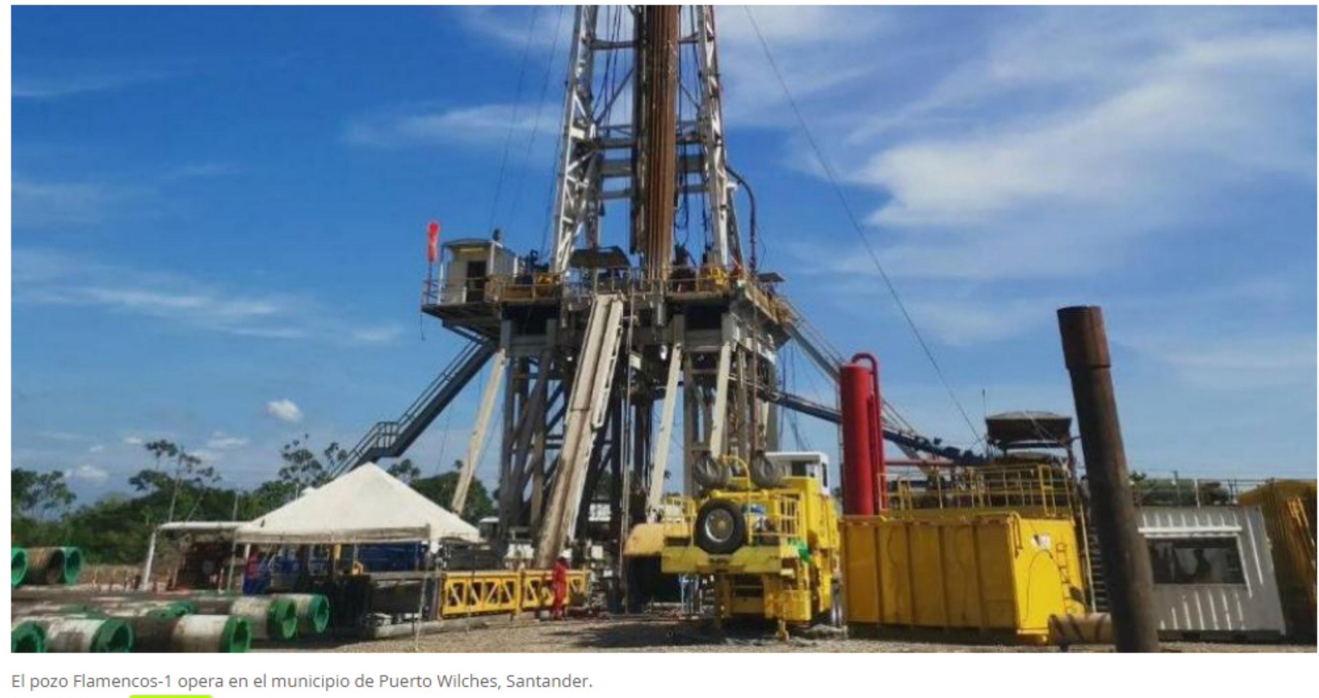
El pozo Flamencos-1 opera en el municipio de Puerto Wilches, Santander. Foto: Cortesía Ecopetrol
