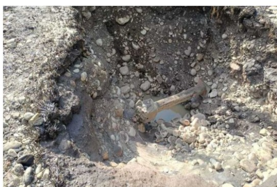
La fuga se presentó sobre Caño Seco, dejando sin agua potable a los habitantes de la vereda Sabanas del Rosario.
