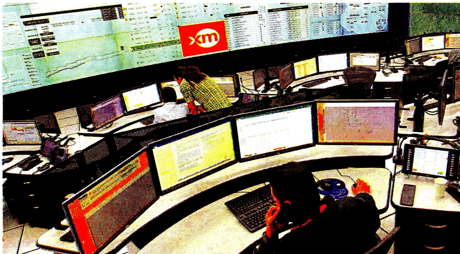
Aspecto del centro de coordinación de XM en Medellín, allí se coordina la operación de la cadena productiva del sector eléctrico colombiano. Archivo
