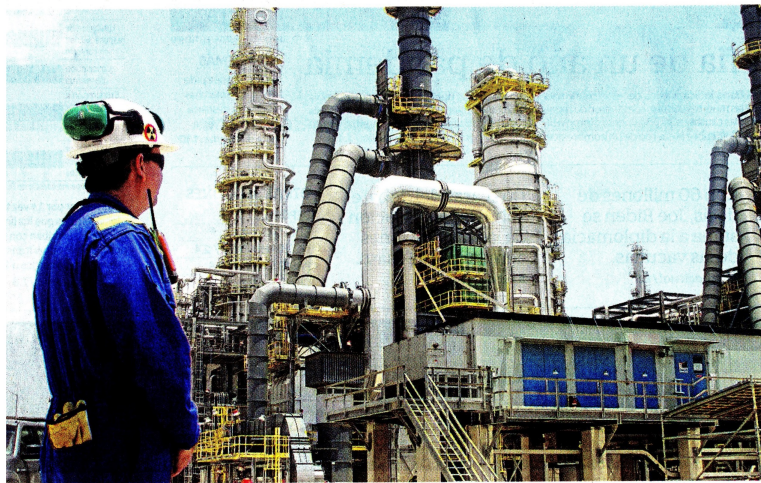
Para la Contraloría, el daño al patrimonio fue producto de las acciones y omisiones de la Junta directiva de Reficar y su administración, contratista y supervisor del proyecto. FOTO: YOMARA GRANDET, EL TIEMPO
