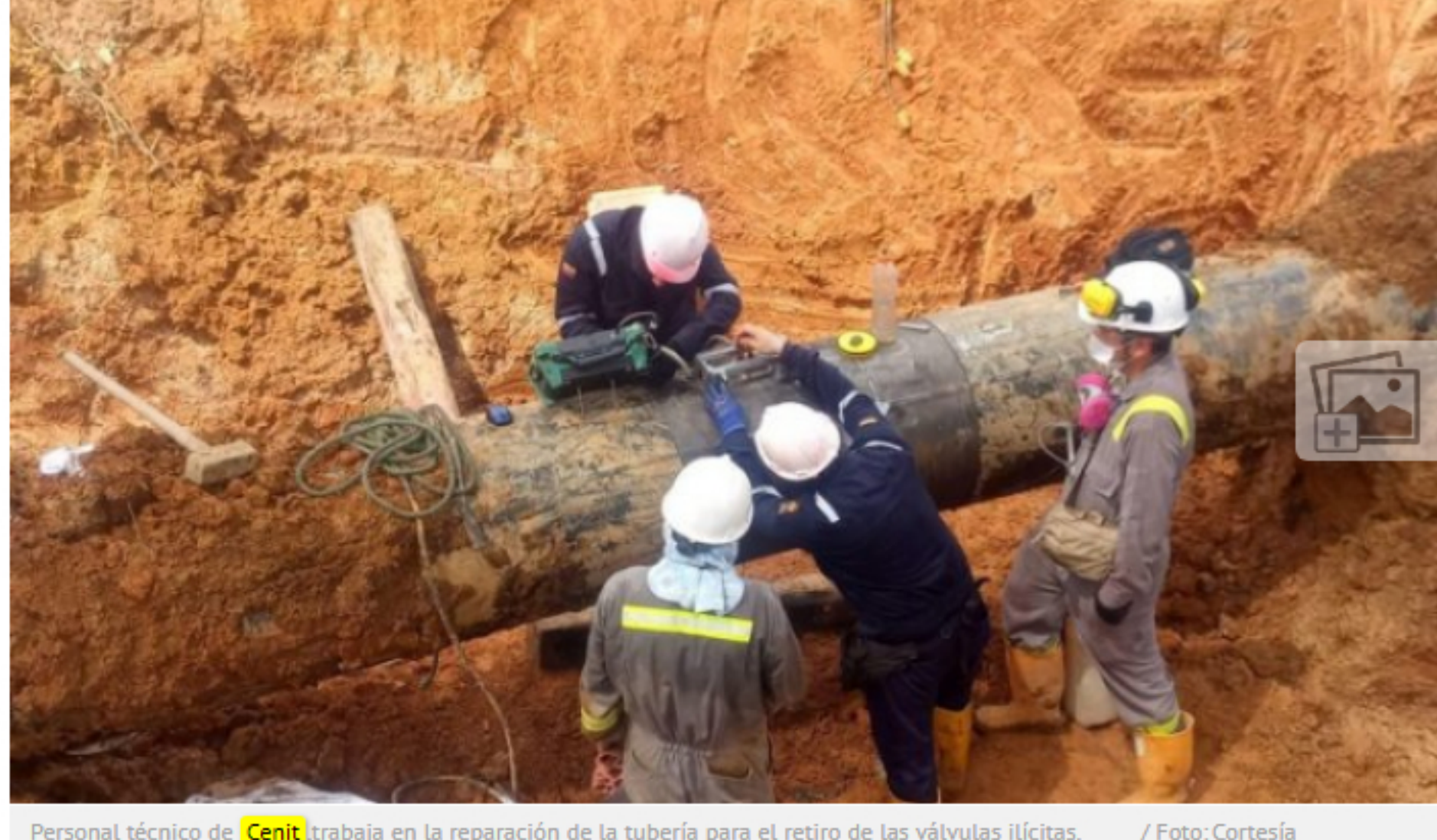
Personal técnico de Cenit trabaja en la reparación de la tubería para el retiro de las válvulas ilícitas. / Foto: Cortesía
